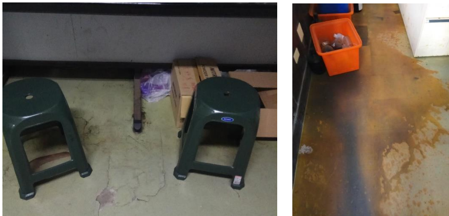
教學實驗地板龜裂(左圖)和受侵蝕(右圖)
